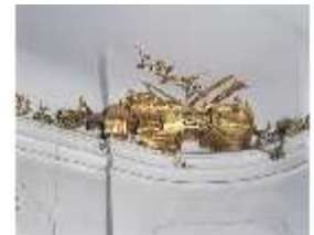
BayNS.II, Deckenstuckdet., Cello, R.1.14, DE001815, BSV-
