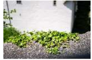
Pr.V, Efeu an der Brüstung, Außenbereich, DI034902, BSV-
