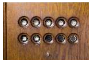
Neusch.II, Vorzimmer, R. 3, Elektr. Klingelanlage, DI002160, BSV
